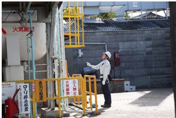
(ガス漏れ発生)
