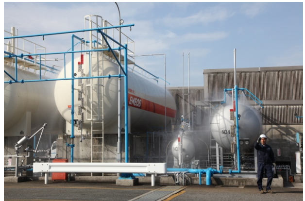
散水装置の作動確認
