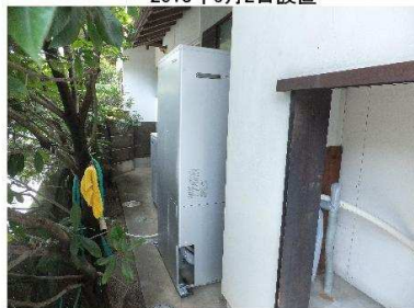
2013年8月1日設置 (W発電・燃転 灯油ボイラー)
