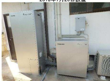
2014年7月18日設置 (燃転 灯油ボイラー)
