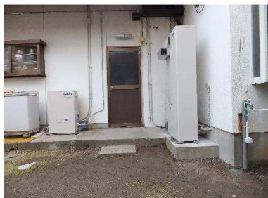
2012年6月8日設置 (W発電・燃転 エコキュート)
